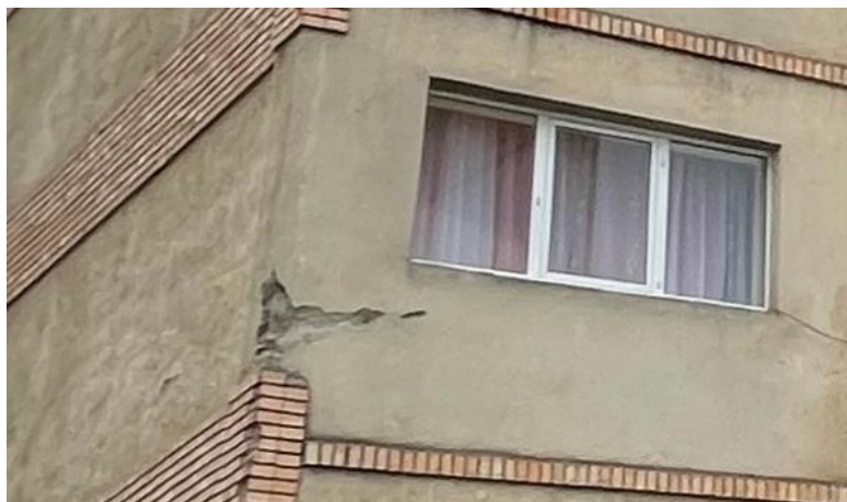
Figura 3: degradare tipică fatada
